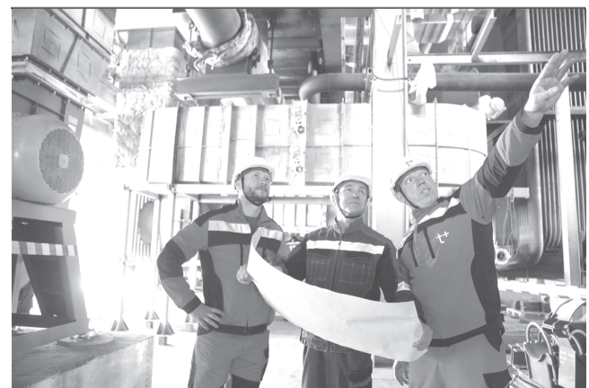
Современная котельная обеспечит качественное теплоснабжение половины областного центра. Фото Д. Рыжакова
